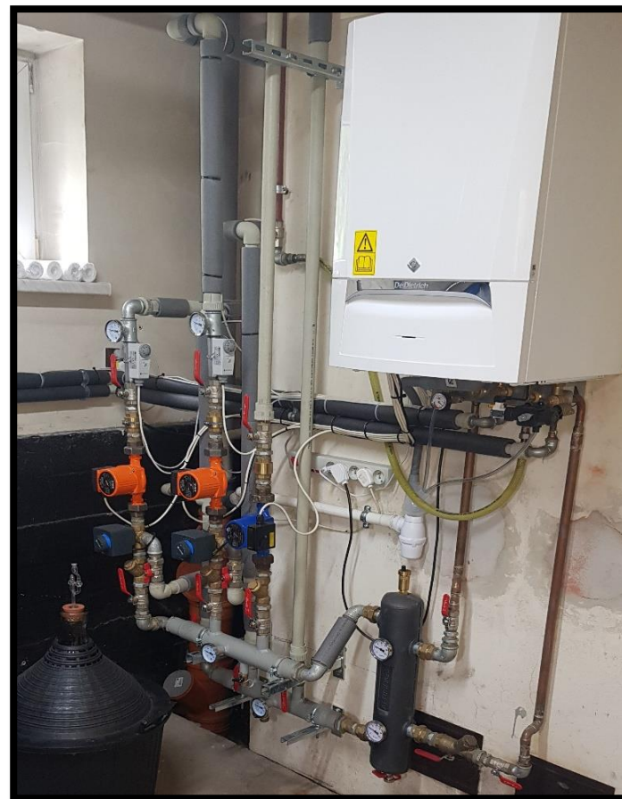
Przykład zmodernizowanej kotłowni w miejscowości Rokiciny Podhalańskie.
