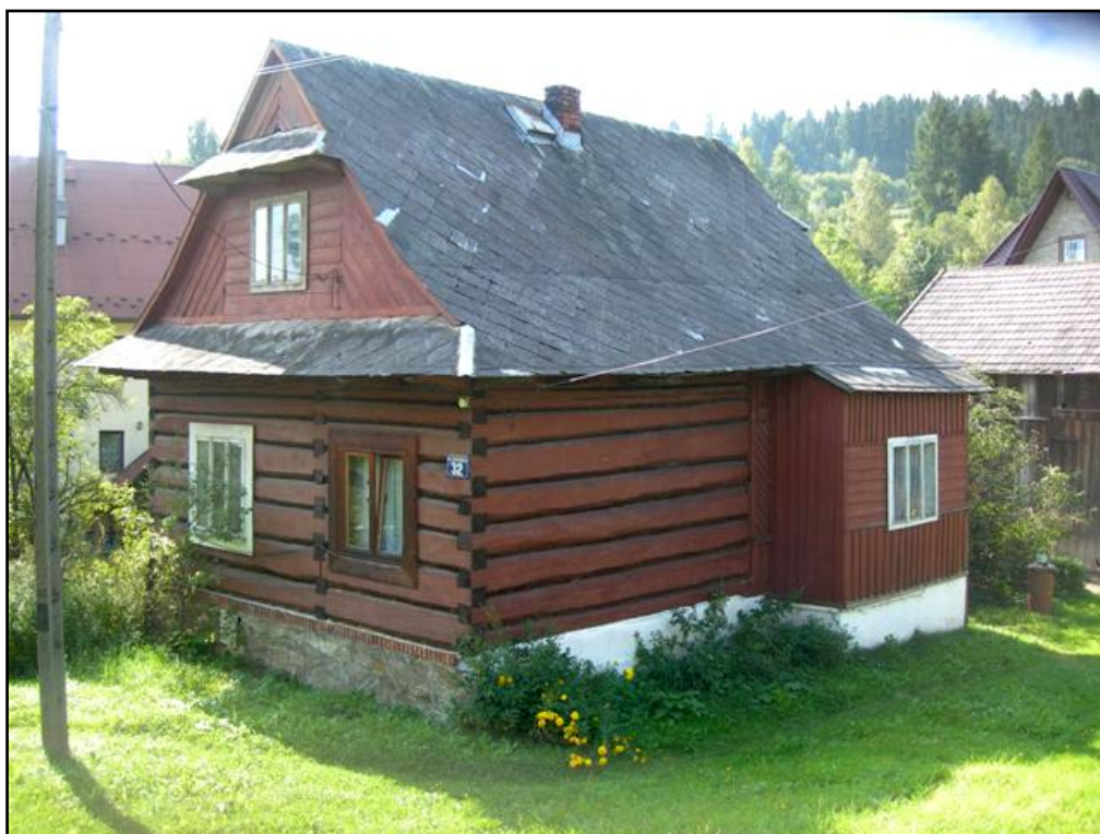
Rys. 5. Zdjęcie obrazujące wykorzystywanie wyrobów azbestowo-cementowych jako element pokrycia dachowego (płyty karo) źródło: zdjęcie własne – inwentaryzacja w terenie
